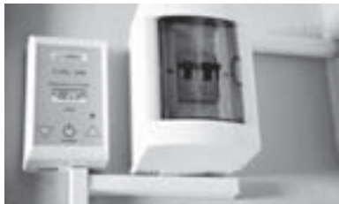
Рис. 20. Терморегулятор, подключенный к сети через отдельный автомат
